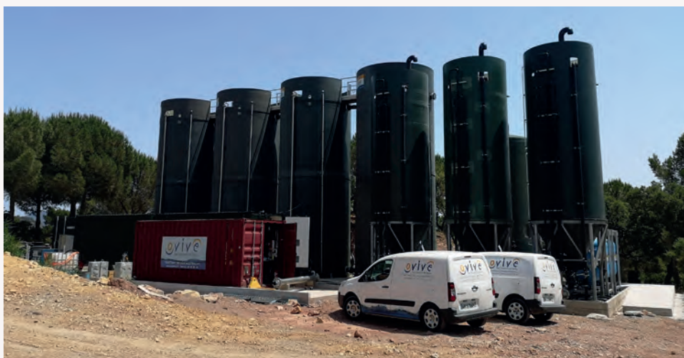
Station d'épuration biologique (BRM : Bio Réacteur à Membranes)
