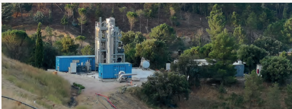
Evapo Concentrateur et chaudière à biogaz
